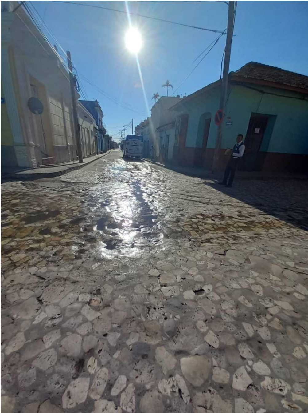
Figura 3 Calle Gutiérrez, arteria principal del centro histórico, salidero de agua.
