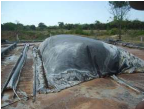
Figura 3- Foto de una laguna de oxidación cubierta para colectar biogás
