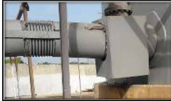
Figura 2. Separación entre la conexión del tanque y la tubería.
