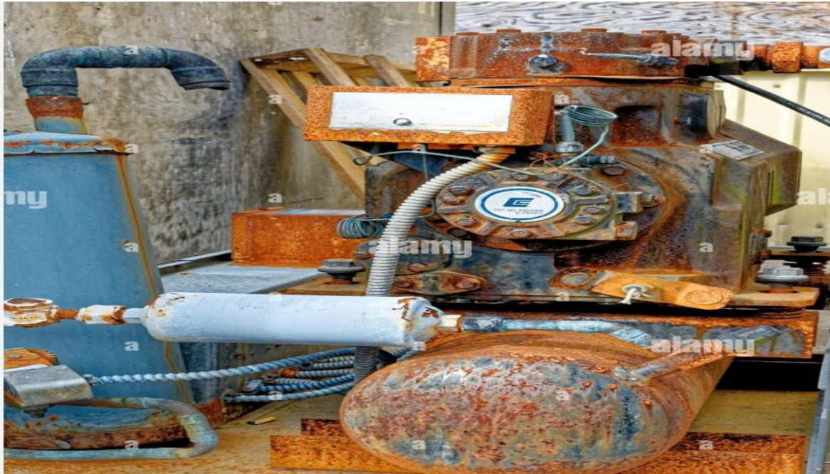
Figura 3.8: Compresor envejecido. Fuente: foto del autor.
