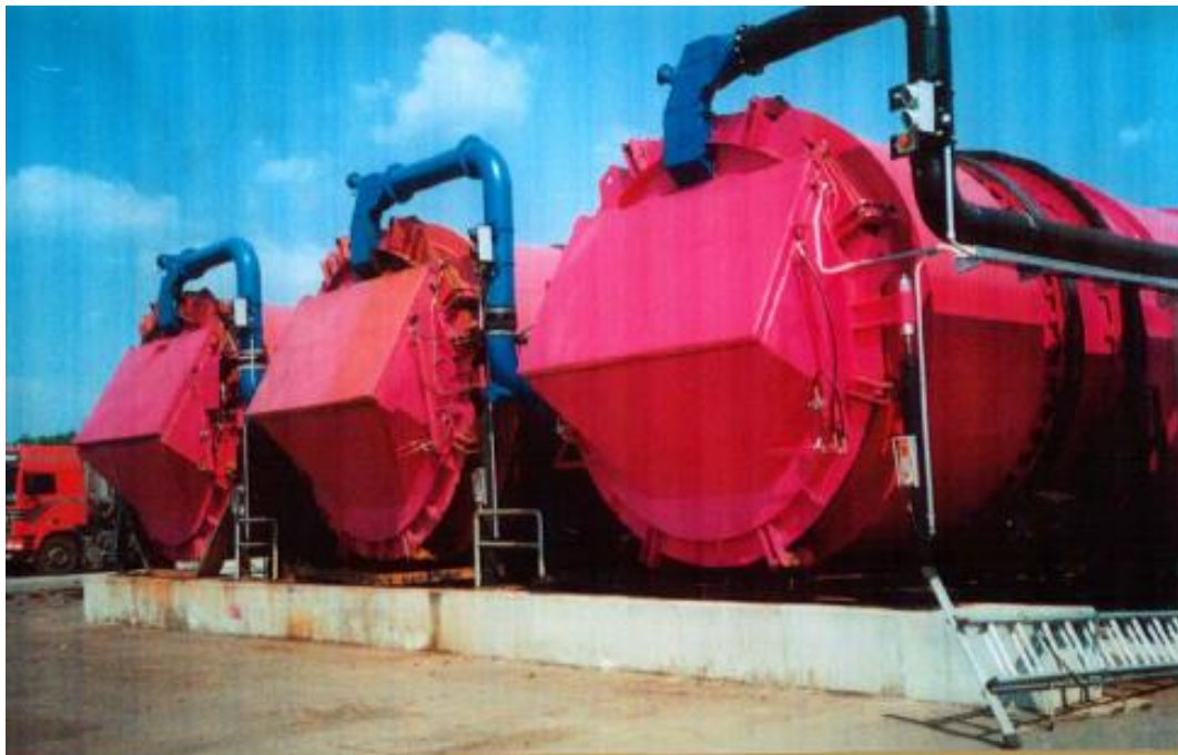
Figura 6. Sistema D: Biorreactores de tamboretes
