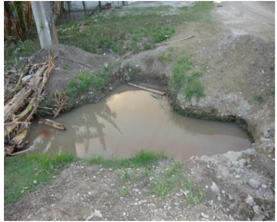
Fig.85-d) Huecos cubiertos por aguas albañales.
