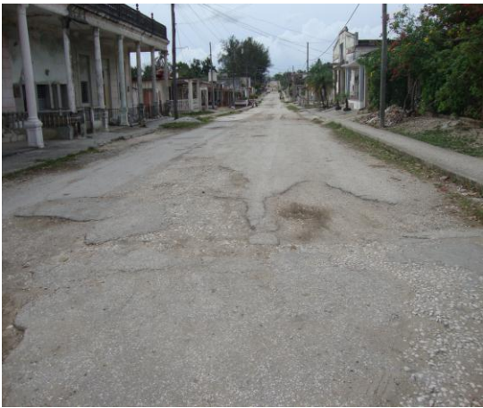
Fig.84-a) Deterioro en la pavimentación.
