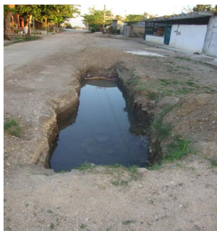
Fig.85-b) Huecos cubiertos por aguas albañales.
