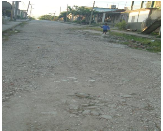
Fig.84-b) Deterioro en la pavimentación.
