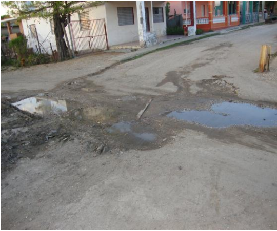
Fig.85-c) Huecos cubiertos por aguas albañales.
