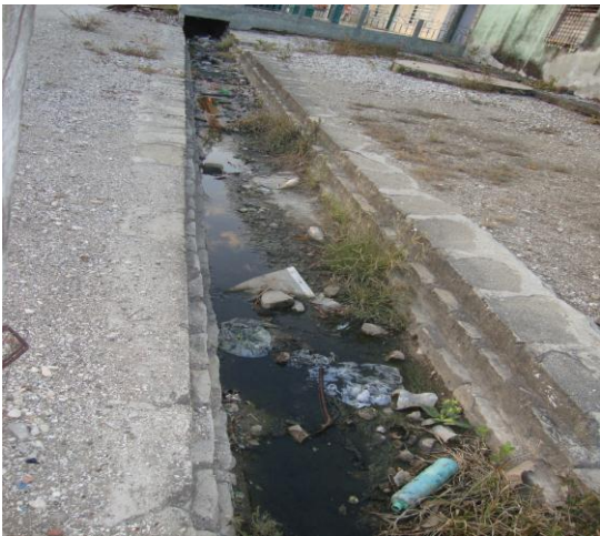
Fig.86-a) Zanjas con residuos.
