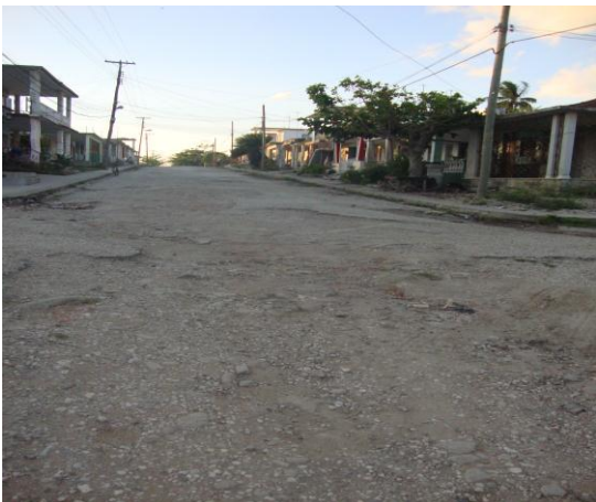
Fig.84-c) Deterioro en la pavimentación.
