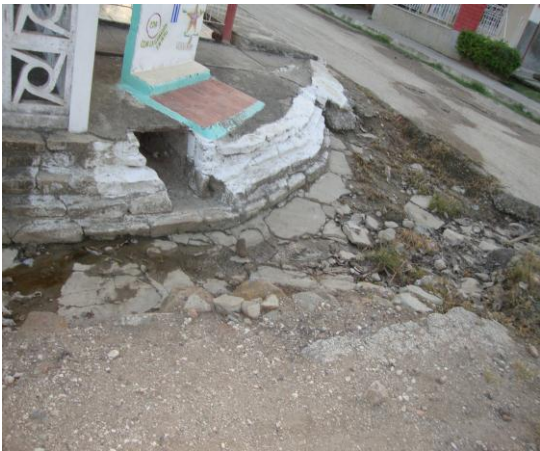
Fig.86-c) Zanjas en derrumbe.
