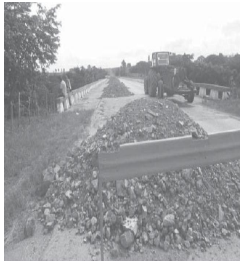
En el puente sobre la carretera de Yaguajay se cerró una senda como medida de prevención. /Foto: Carmen Rodríguez
