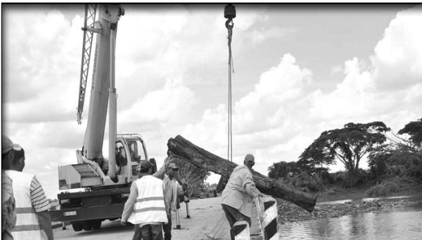
Intensos trabajos requirió la desobstrucción del puente sobre el río Zaza en la Carretera Central.
