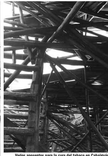
Varios aposentos para la cura del tabaco en Cabaiguán quedaron en estado ruinoso. En la foto, uno de la cooperativa Nueva Cuba. /Foto: Aramis Fernández
