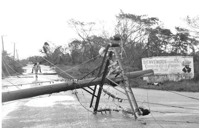
La infraestructura eléctrica fue severamente dañada. /Foto: Vicente Brito
