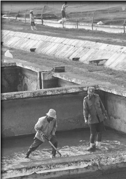
Entre las instalaciones más golpeadas en el territorio figura la Estación de Alevinaje de La Sierpe.
