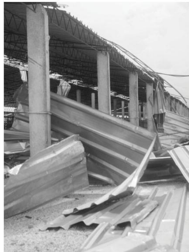
Así estaban las instalaciones del nuevo centro integral porcino de Carbó, tras el paso del huracán. /Foto: Vicente Brito
