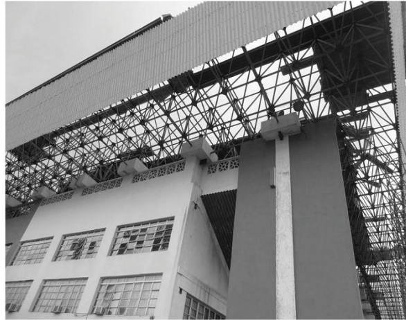
Parte de los techos del Polideportivo Yayo fueron al piso. /Foto: Reidel Gallo
