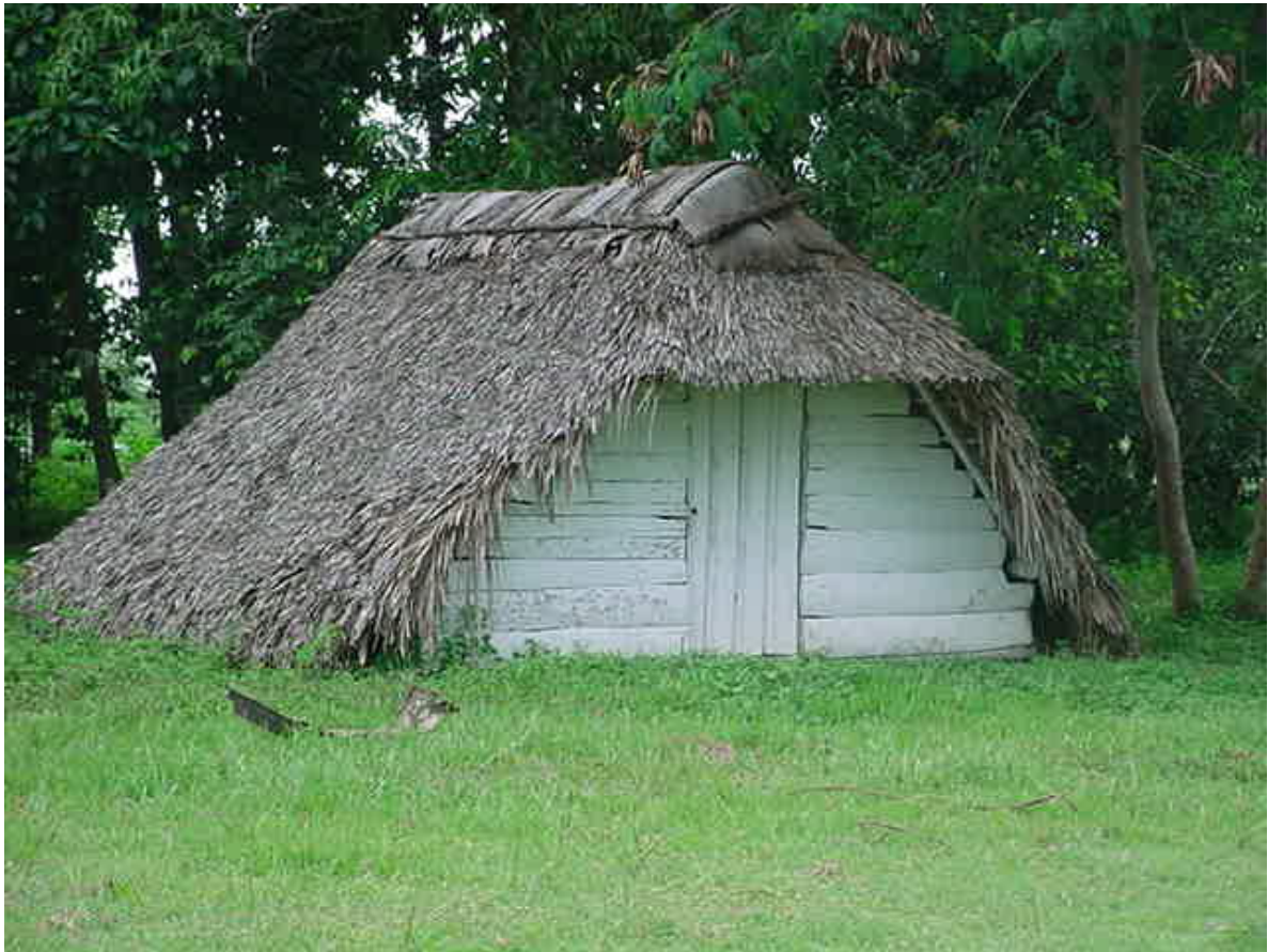
Imagen # 30. Edificación conocida como rancho valentiera, prácticamente desaparecidos del paisaje campesino de la zona, se utilizaba como almacén de aperos de labranza, por ser de bajas dimensiones era muy apreciado por la resistencia que hacen a los ciclones tropicales, lo que permitía que la familia campesina se guareciera.
