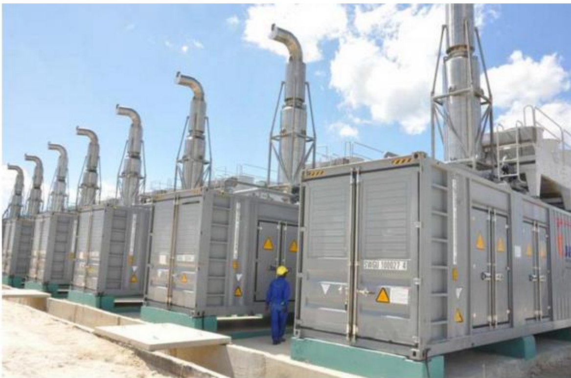
En el parque industrial se instalan 40 motores, repartidos en cinco baterías, encargados de generar 84 Megawatts/hora. Foto: Julio Martínez Molina
