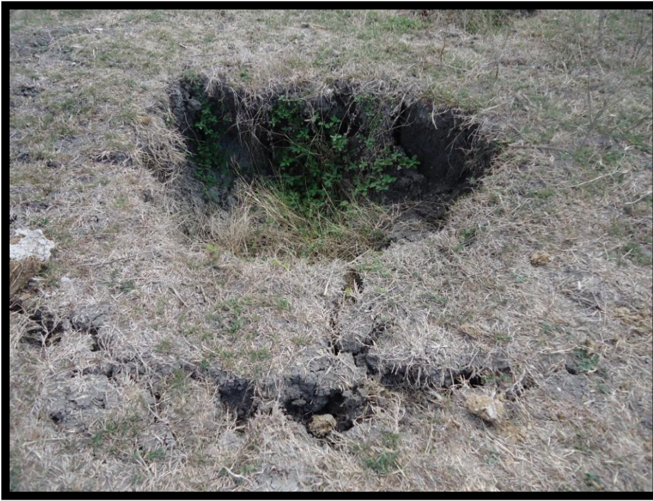
Figura. 4.15: Erosión subsuperficial asociada a las grietas de desecación (proceso vértico) en el área de retrocárcava.
