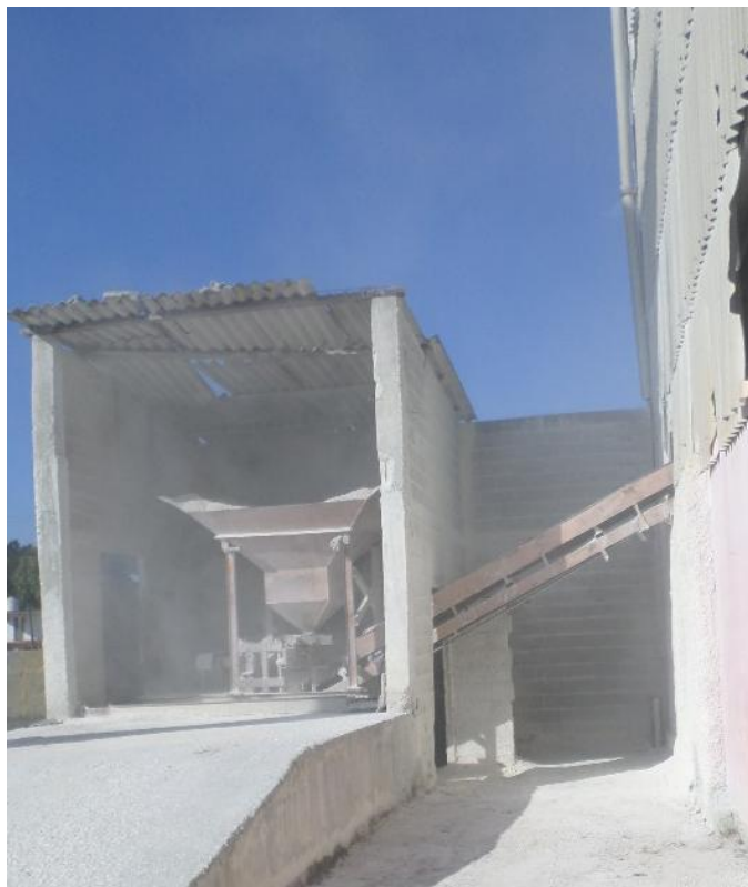
Generación de polvo en la UEB Hormigón
