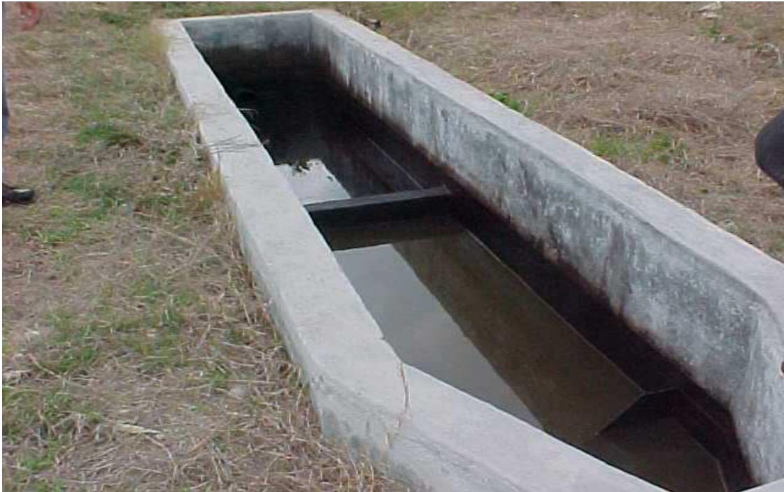
Foto # 13: Planta de Destilación (Medidor de flujos de Sistema de Residuales)
