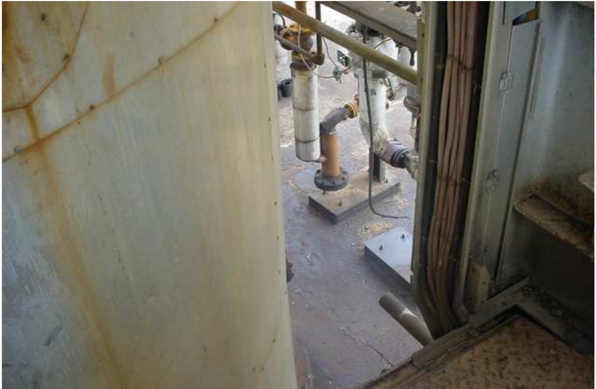
Foto # 5: Tuberías sin insulación (aislante térmico) de la Planta de Destilación al Vacío
