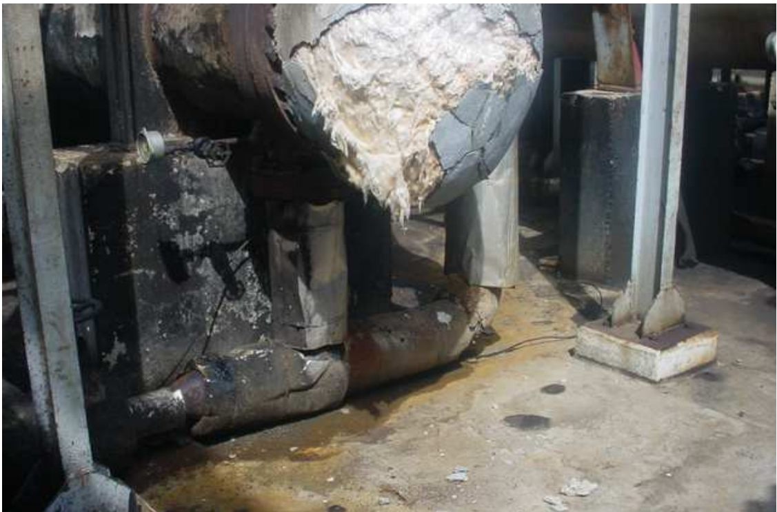
Foto # 2. Intercambiadores de calor de la Planta de Destilación
