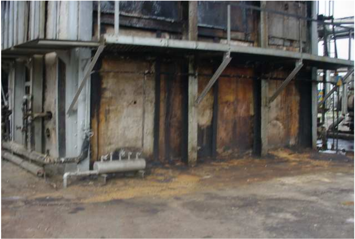
Foto # 7: Planta de Destilación (Horno F-101).
