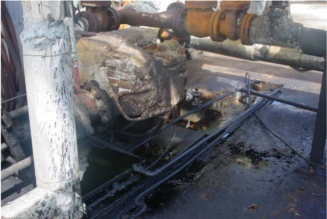
Foto # 3: Bomba reciprocante de la Planta de Destilación
